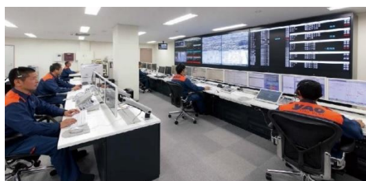
高機能消防指令センター
