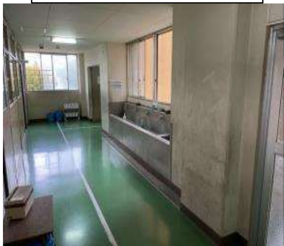
3階：北館 廊下給水設備
