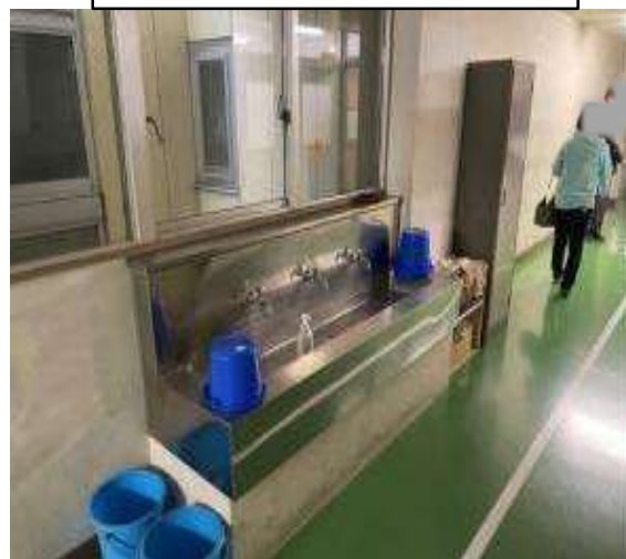
2 階：北館 廊下給水設備
