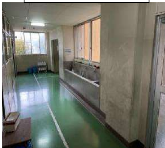
4階：北館 廊下給水設備
