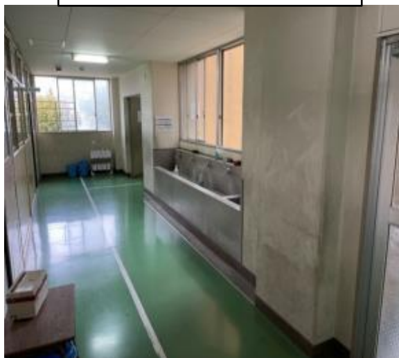
4階：北館 廊下給水設備
