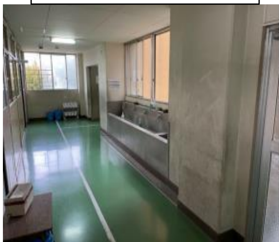
3階：北館 廊下給水設備
