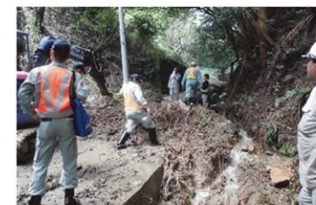
八尾市での被害(太田川)
