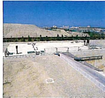
浸出水調整槽
