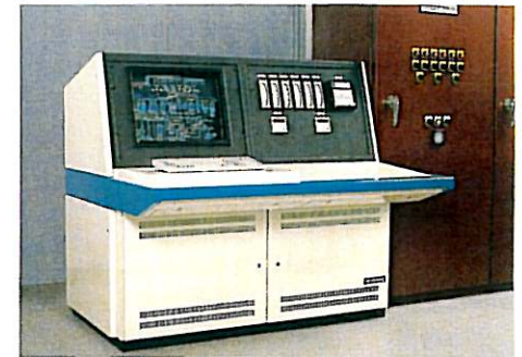
中央監視制御装置
