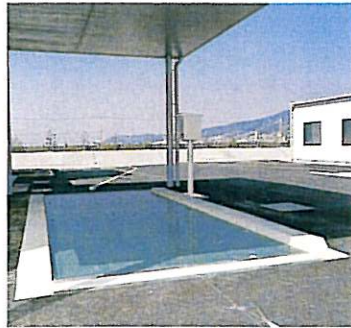
トラックスケール
