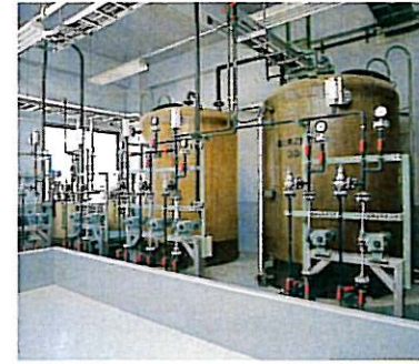
薬品注入設備
