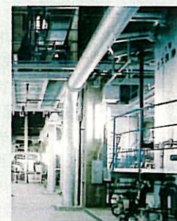
㉑排ガス洗浄装置… 排ガス中の塩化水素等を洗浄処理します。
