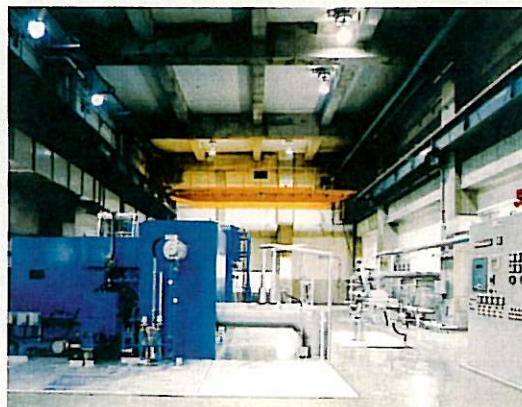
蒸気タービン発電機… ボイラで発生した蒸気により発電します。出力14,500kw。
