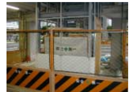
【エレベーター (構外)】
