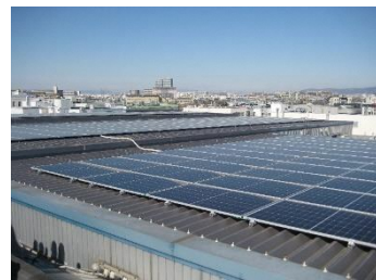
太陽光パネル
