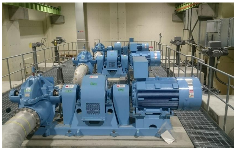
高安受水場送水ポンプ
