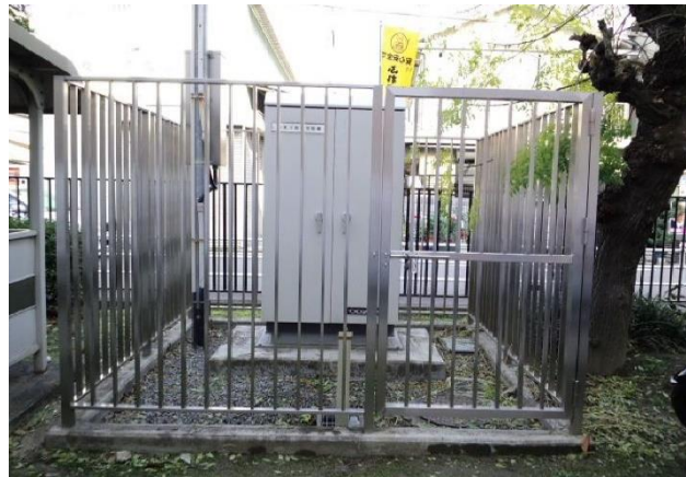
水質自動監視装置
