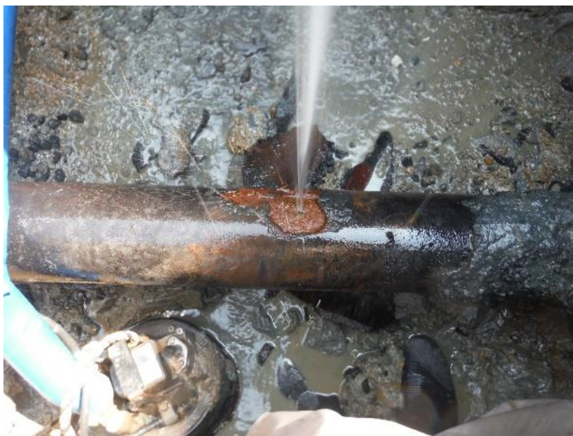
老朽化した铸铁管の漏水状況
