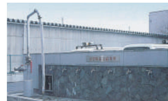
●災害時応急給水栓
