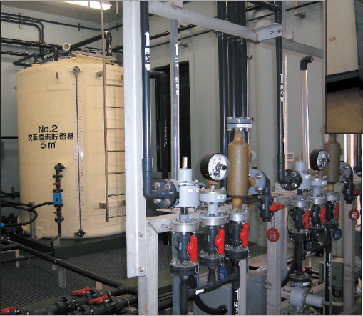
●塩素注入設備
