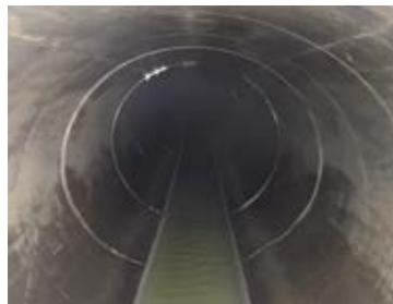
安心安全な生活環境の確保のため、下水道施設の計画的な耐震化が進められる。
