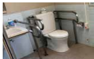
12施設あるコミセンのうち、緑ヶ丘・南高安・久宝寺は温水洗浄便座が未設置である。
