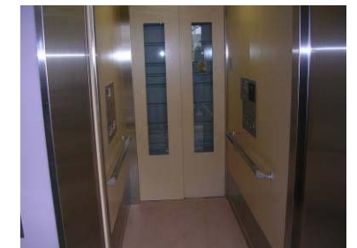
エレベーターの設置例
