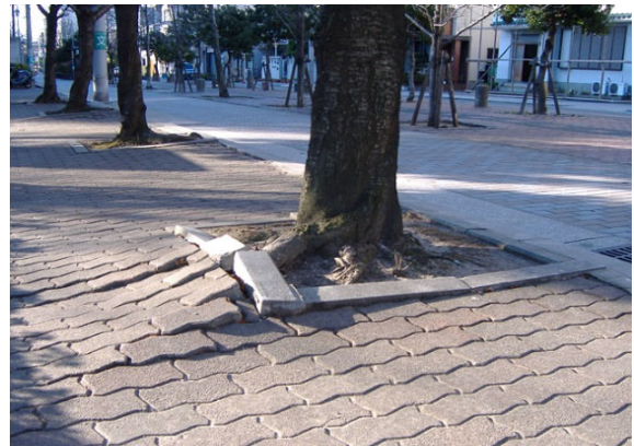
根上がりによる通行支障
