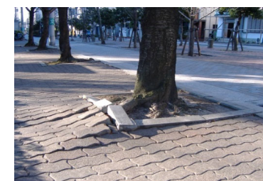
根上りによる通行支障
