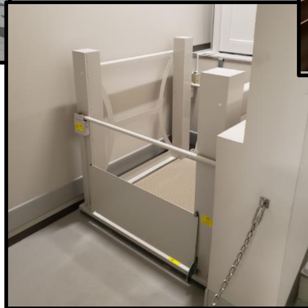
楽屋通路の段差解消機
