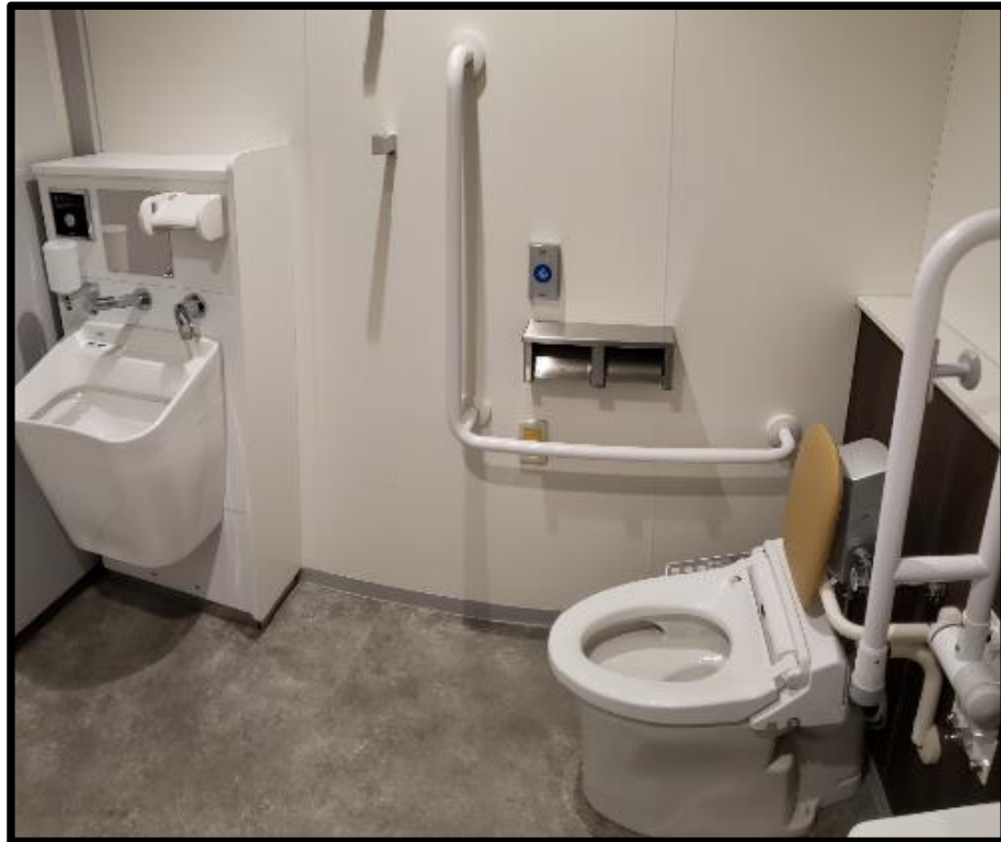
オストメイト設備
