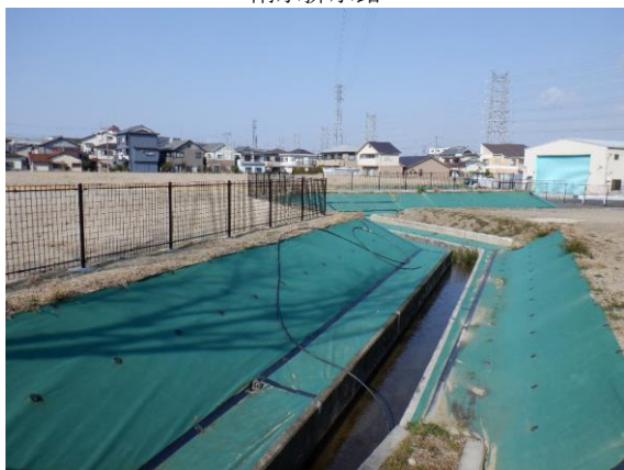
水路転落防止用のフェンス
